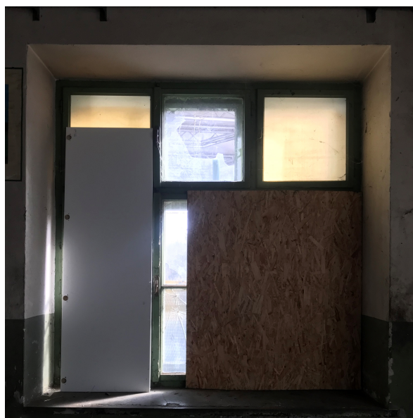
Slika 19: Manjkajoči elementi odprtin stavbnega ovoja, prekriti z lesenimi ploščami
